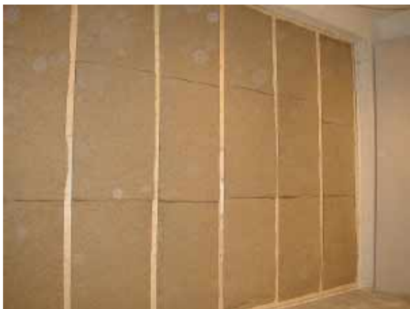
Figur 3.9. Høruldsplader i væg nr. C2 umiddelbart før montage af to lag gipsplade fra modtagerummet
